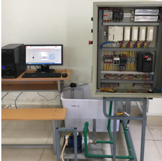
Hình 4. Phần cứng hệ thống điều khiển mức và cơ cấu chấp hành
